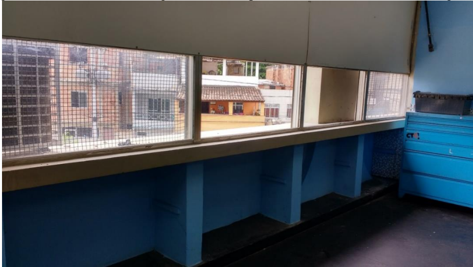
Figura 15 - Janelas sem vidro e grades de frente para as residências do bairro de Manguinhos
